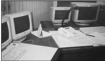
Obr. 29 Ovládací pracoviště v ŽST Stará Boleslav (reprodukce ze Signal und Draht č. 6/1998; článek autorů Ing. Bohumil Nádvorník a Ing. Pavel Pešek)
